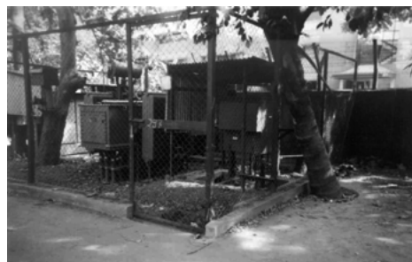
Рис. В54. Подстанция наружной установки без корпуса
